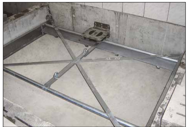
▲ Dungklappschieber am Kanalende
