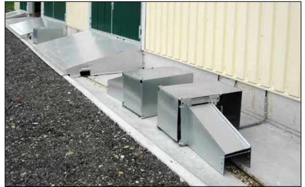
▲ Antriebswinden EW4 und Querkanalabdeckung
