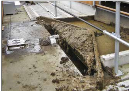
▲ Faltschieber am Abwurf
