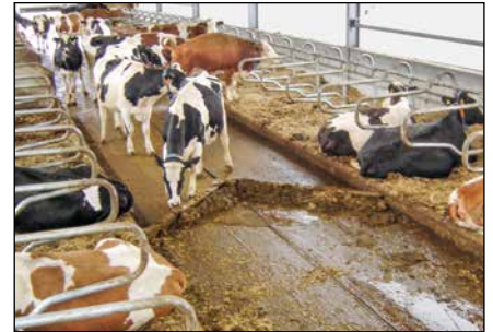
▲ Faltschieber im Laufgang
